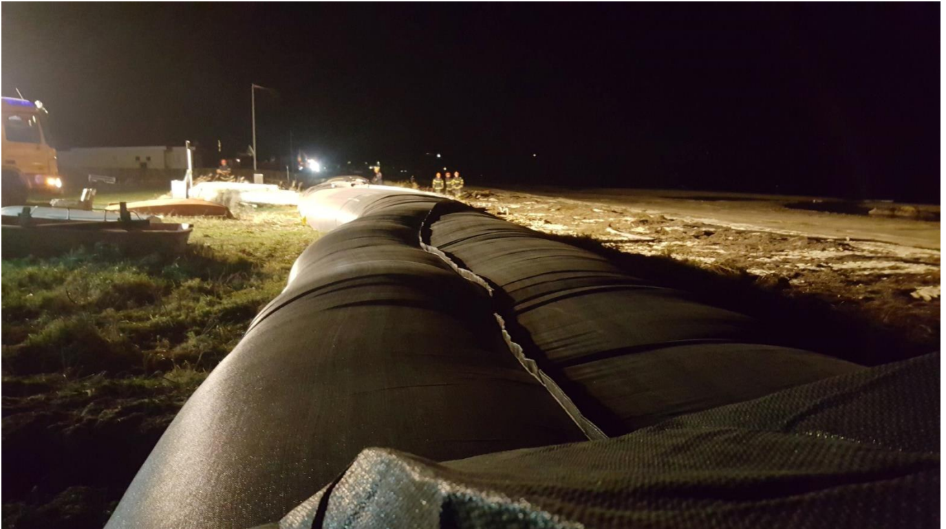
Beredskabsstyrelsen havde 130 personer indsat til at forhindre større oversvømmelser i kølvandet på det kraftige blæsevejr fra nytår til 2. januar.
