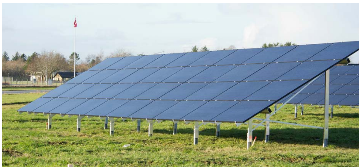
Solcelle anlæg på Flyvestation Skrydstrup.
